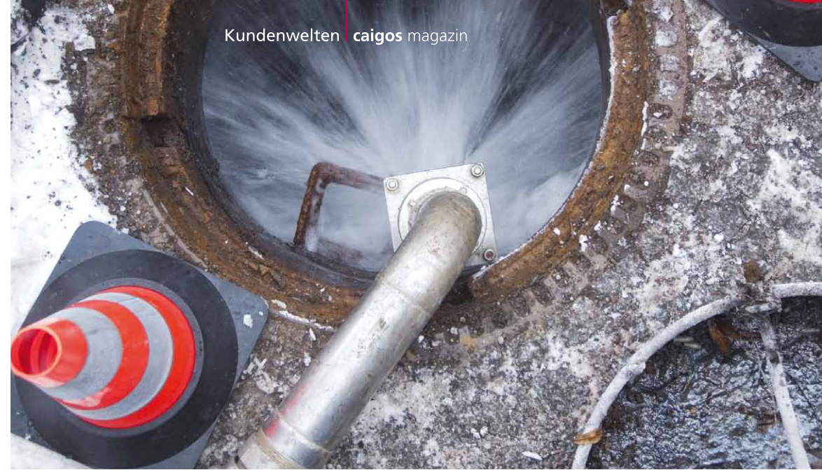
Kanalspülung: Wasser wird per Hochdruckpumpe und Hochdruckschlauch durch eine Reinigungsdüse an die Kanalwand gespritzt, oder wie hier zur Schachtreinigung verwendet.
